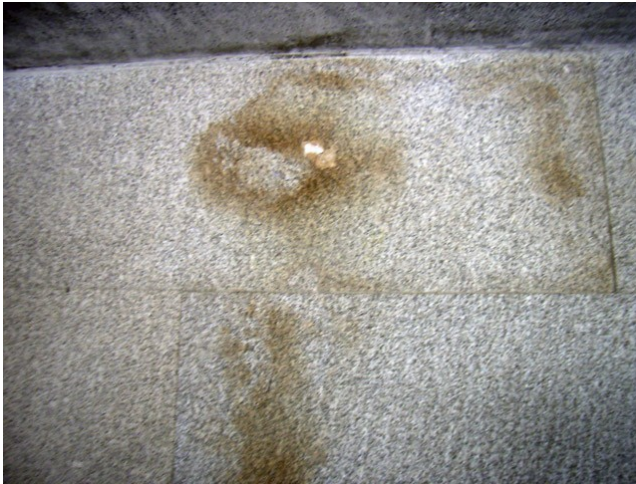
Abbildung 1: Braune Verfärbungen an Natursteinplatten
