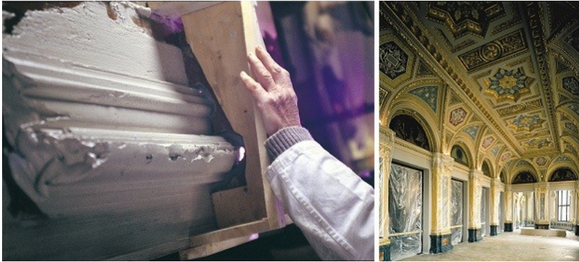
Abbildung 5: Links: Modellieren des Stuckgipses mit einer Holzschablone Rechts: Stuckarbeiten in der Alten Oper in Frankfurt am Main
