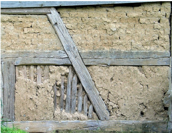
Abbildung 1: Fachwerksausfachung mit Lehmputz im verwitterten Zustand (Foto: wikipedia.org )
