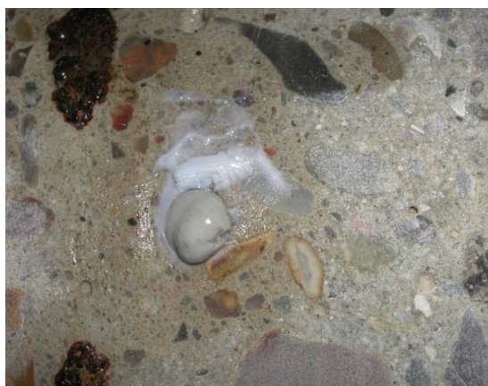
Abbildung 1: Austritt von Gel aus Beton bei der schädigenden Alkali-Kieselsäure-Reaktion. (Foto: F. Tralow, TUHH)
