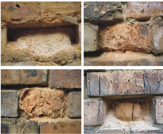
Abbildung 3: Ziegelschäden: Absanden (Rückwitterung) mit massiven Salzausblühungen (o.l.), Abschuppen und Bildung dünner Schalen (o.r. und u.l.) und Absanden mit massiver Rückwitterung bzw. Verlust des Ziegels (u.r.)
